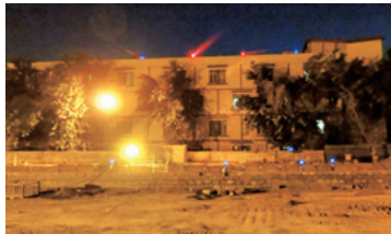
ニューデリーの地下鉄工事現場でのOSV (赤青の光) による安全管理
