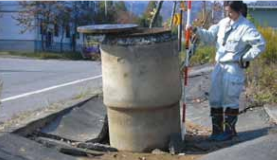
地震の液状化によるマンホールの浮き上がり
