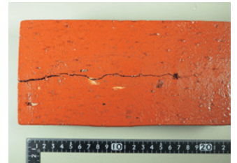
図1：凍結融解作用によりひび割れが生じたレンガ
