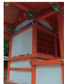
文化財外壁の汚れ
